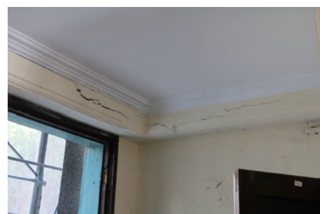
●本館教室教室區 1 樓北側樓板 RC 劣化
