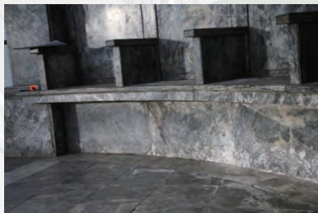
●禮拜堂講台大理石水化損壞
