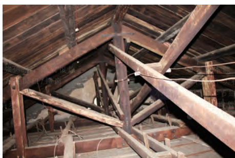
●本館教室屋頂，發現清朝時代的福杉木仍保存良好（照片中圓柱形木材）。
