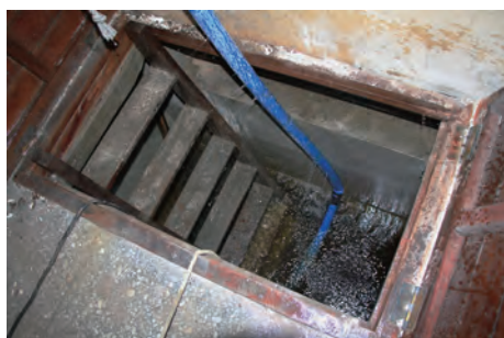
●禮拜堂地下室積水
